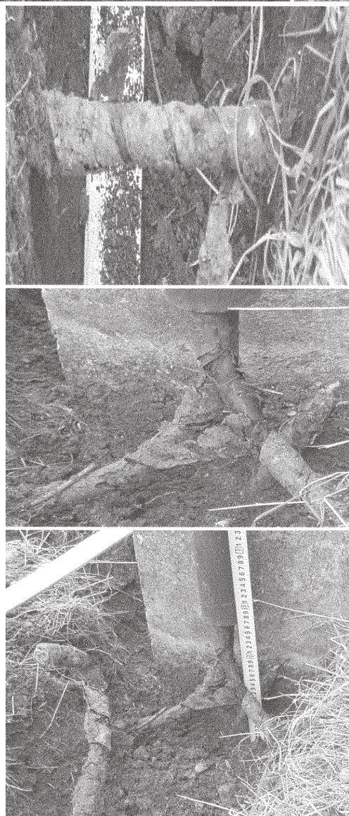
Fig. 3. Starea de coroziune a cablurilor de semnalizare și de telecomandă
