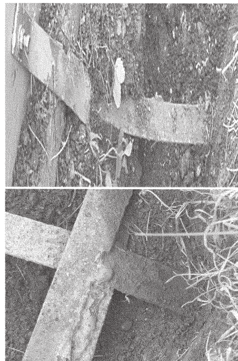
Fig. 8. Imagini privind starea de coroziune a unor platbande pozate în anul 2001
